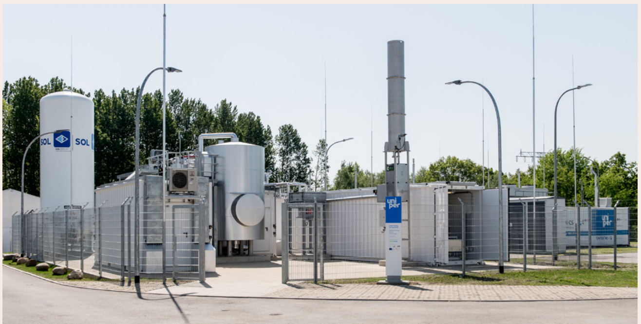
Bild 2: Pilotanlage WindGas Falkenhagen
